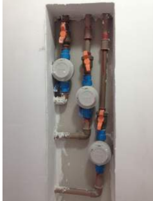
Imagem - Medidores individuais de água, localizados no hall dos apartamentos
