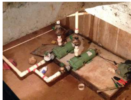
Imagem - Bombas de recalque instaladas no junto ao reservatório inferior
