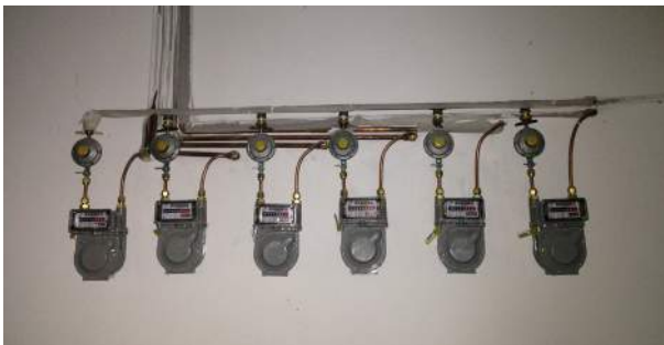
Imagem - Medidores de gás, instalados na garagem do pilotis
