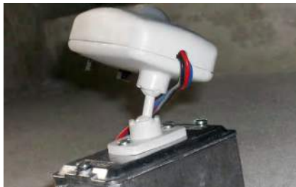
Figura- Sensor de presença instalado nas escadas.
